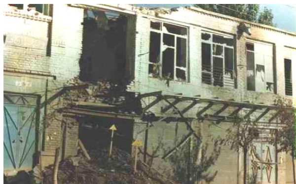
منطقه مسکونی مرکز شهر سردشت که هدف بمبهای شیمیایی قرار گرفت
